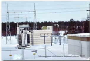
Pelkosenniemen sähköaseman laajennus valmistui 1992.
