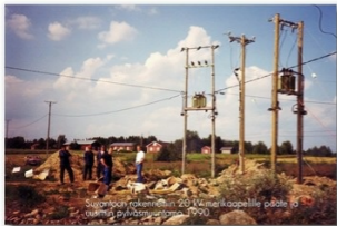
Suvantoon rakennettiin 20 kV merikaapelille päätte ja uusittiin pylväsmuuntamo 1990.
