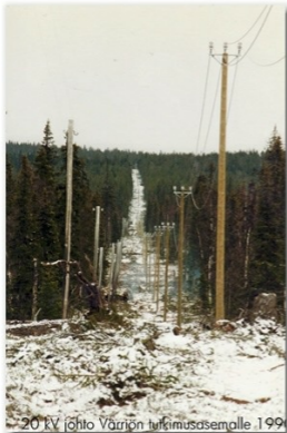
20 kV johto Värriön tutkimusasemalle 1990.
