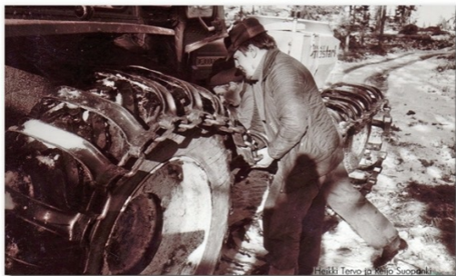
Heikki Tervo ja Reijo Suopanki asentavat teloja Kuoskun johdolla 1978 ja aloittavat pylvåiden uusimisen.
